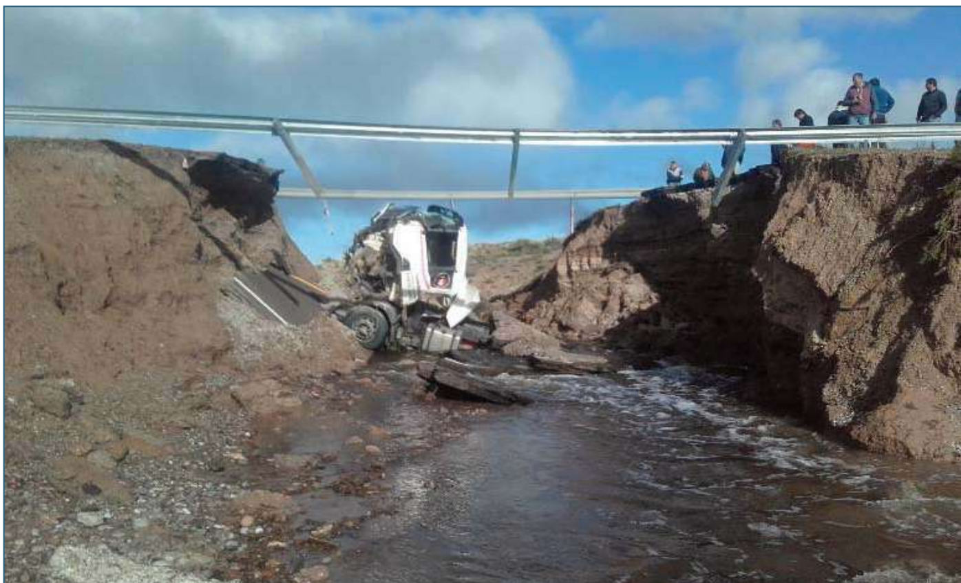
Rotura en ruta nacional número 3, cercano al Paraje Garayalde, por temporal de lluvia en Argentina.
