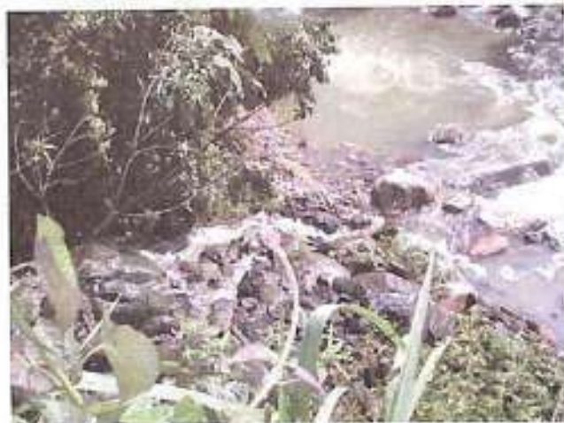
Desfogue del alcantarillado al río Pan de Azúcar.
