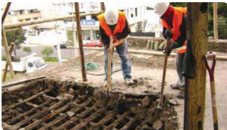
Casa Aranjuez. Retiro de elementos en estado de pudrición en la losa. Fuente: Ministerio Coordinador de Patrimonio.
