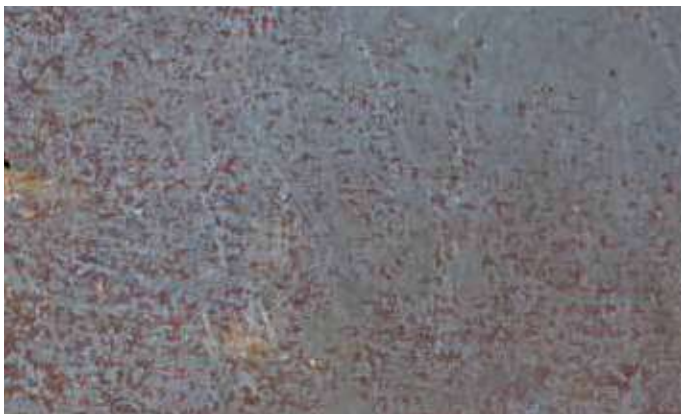
Manchas por oxidación del metal y suciedad
