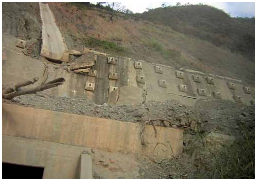
Deslizamiento en la carretera Cotapata - Santa Bárbara.
